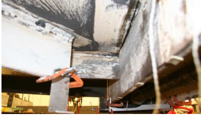
(d) Bolt failure of gusset plate[7]
